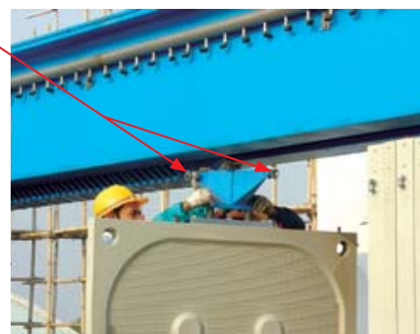
滤板藉滤板架悬垂安装于悬梁下方
