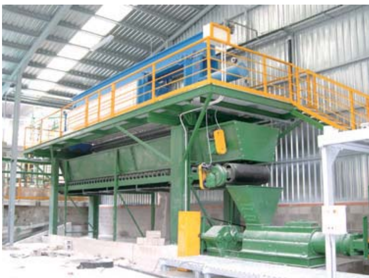
经排泥导板，皮带输送机，及泥饼输送泵等外送方式
